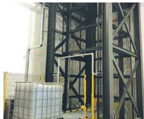
ELEVATORE IDRAULICO AD ALTA VELOCITÀ (2)
